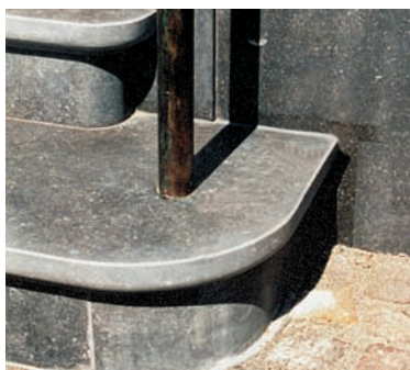
Pérdida de color en la piedra natural después de aplicar la cinta adhesiva
