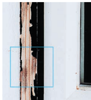
Desconchado en viejos cubrimientos con cintas adhesivas incorrectas – demasiada adhesión
